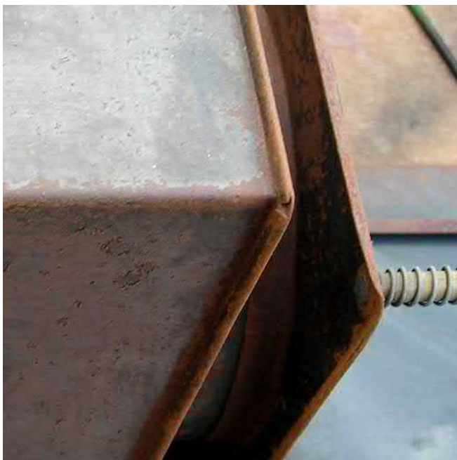
Fig. 4. Corrosion localisée des tôles bronzées
